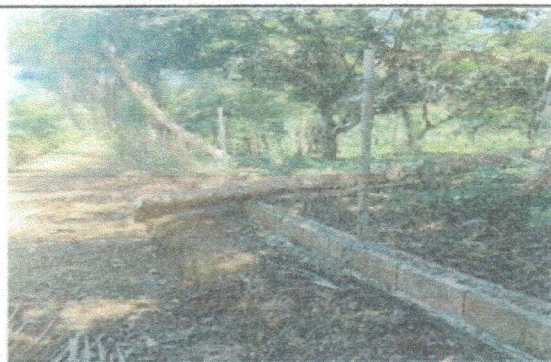
Foto 3: Muro perimetral dañado.
