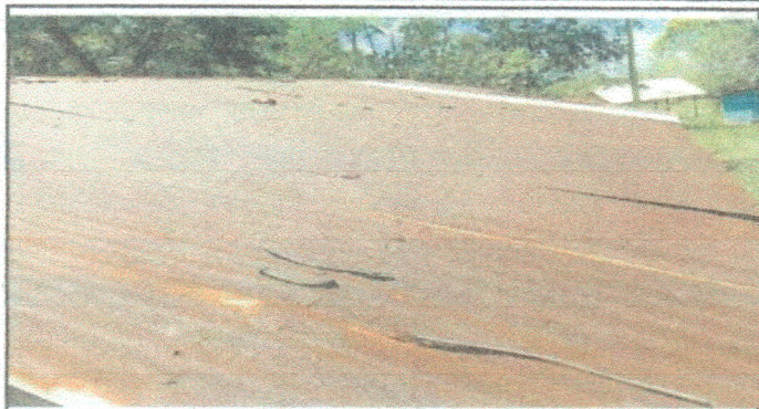
Foto 2: Techo de ambiente a remozar donde se observa el deterioro.
